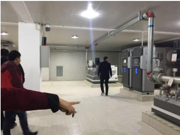
项目地下设备间：泵房
