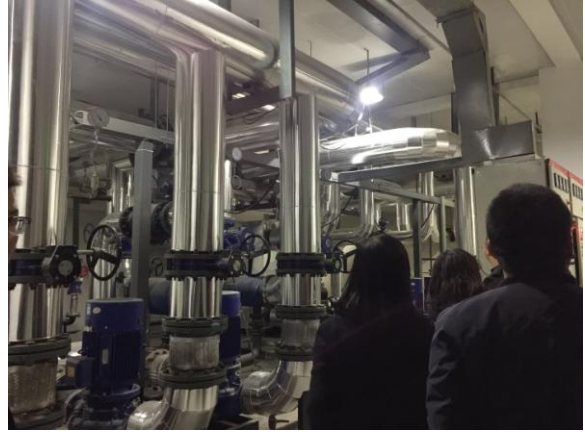
项目地下设备间：换热站
